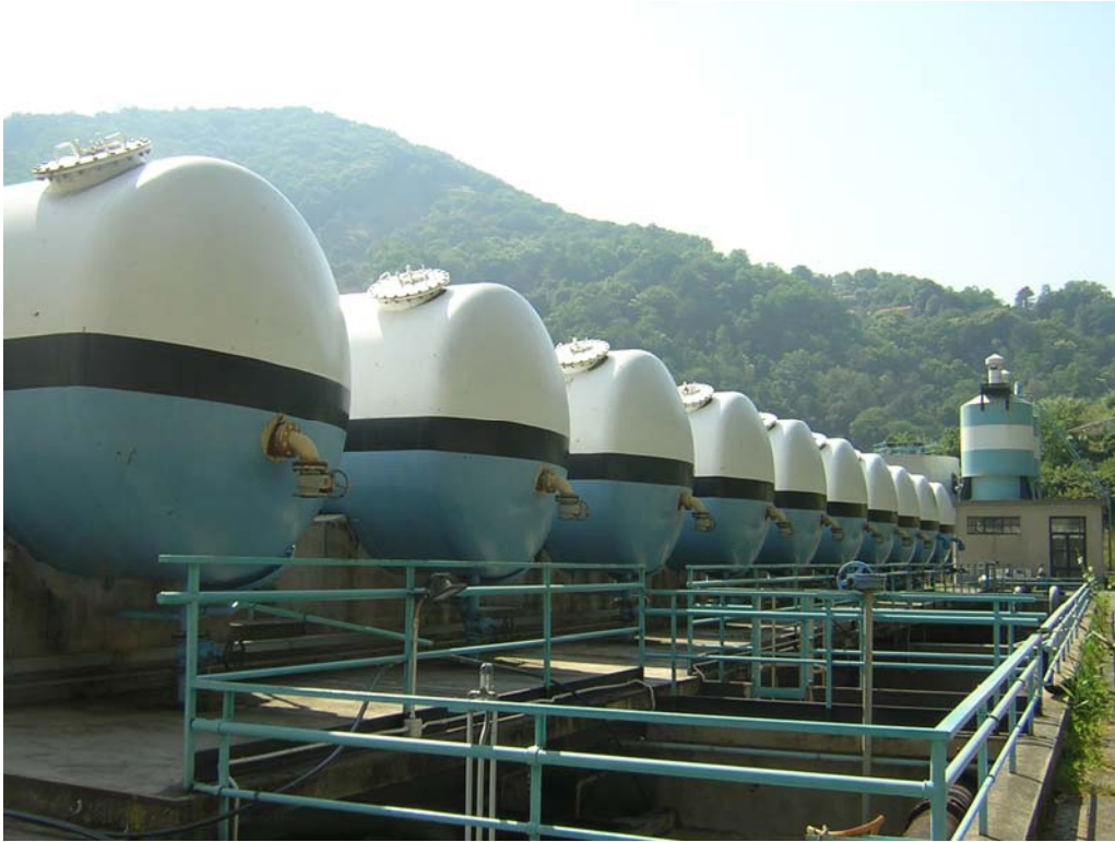
Fig.2: Batteria di filtri a carbone attivo operativi presso un moderno acquedotto
