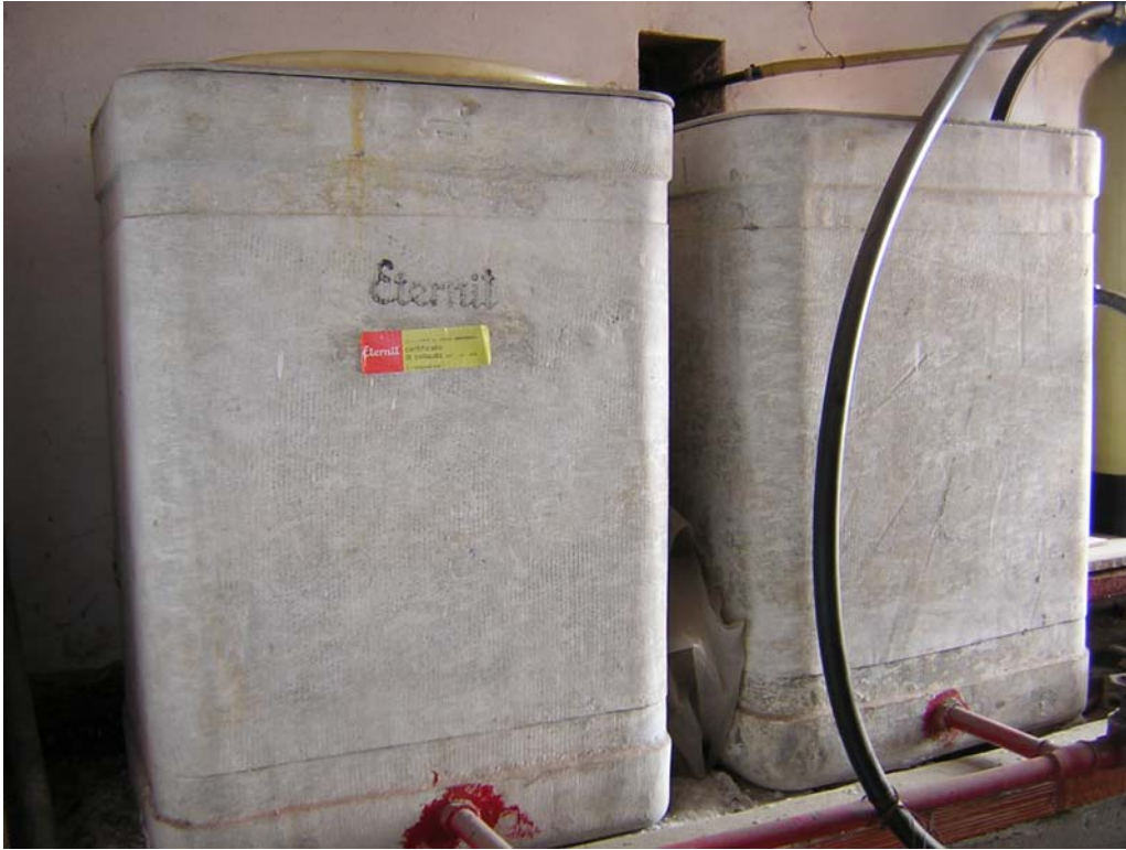
Fig.3: Vasche di accumulo in eternit in uso presso un'abitazione privata.
