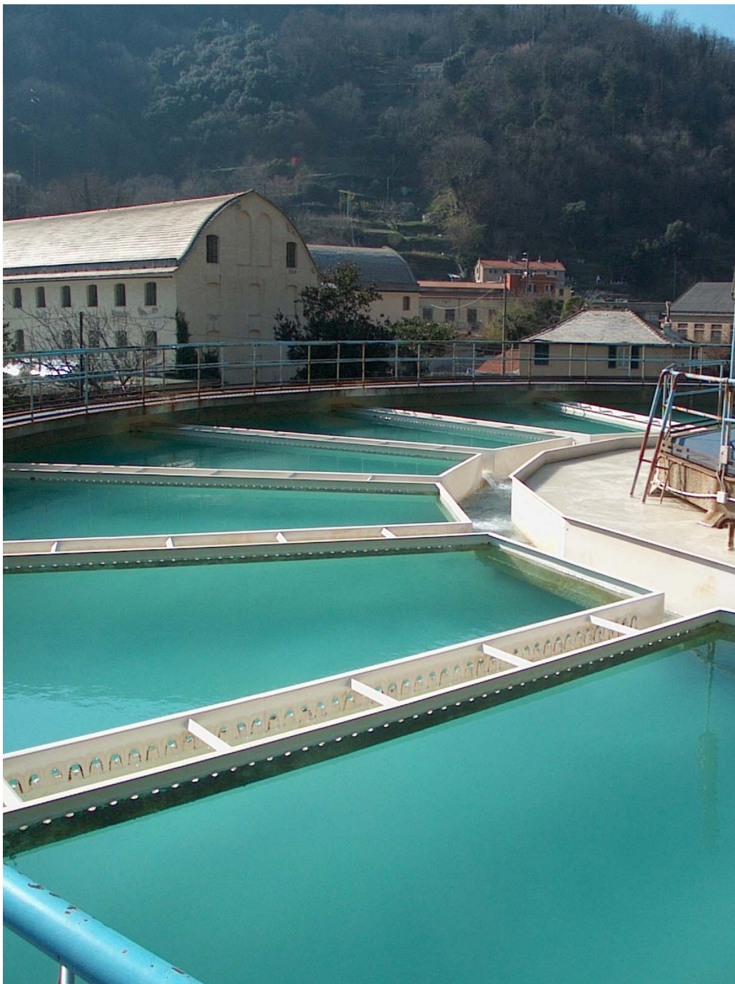
Fig.7:Chiariflocculatore "Accelator", questa tecnologia in uso nei moderni acquedotti consente di rimuovere il materiale in sospensione generalmente non eliminabile con la classica filtrazione
