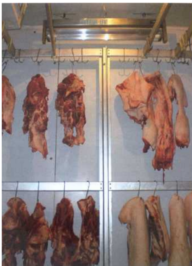
Fig. 2 - Sistema Sitair UV 140 S installato in cella frigorifera ventilata.
